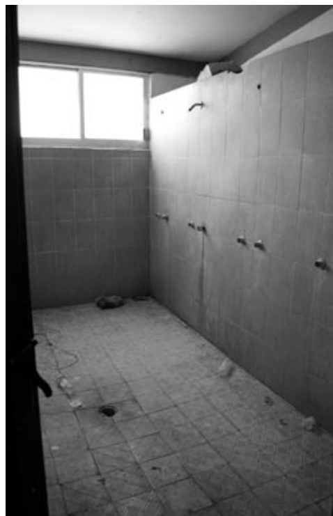
» Aspecto de las instalaciones de regaderas deterioradas dentro del internado de la Normal de Ayotzinapa.
